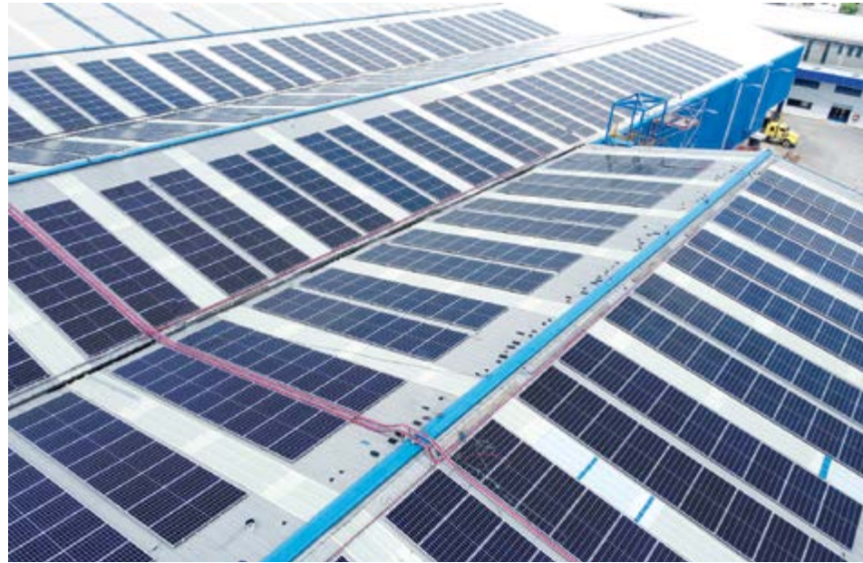
>> Planta fotovoltaica de capacidad de 1 MW que será duplicada a 2 MW este 2024.
